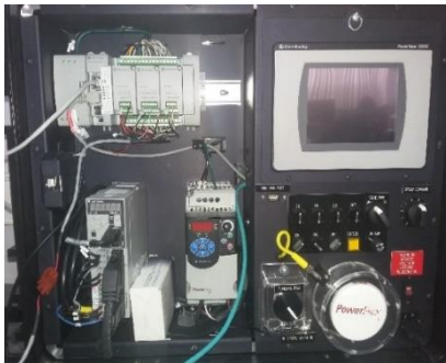
Controlador e Interfaz
