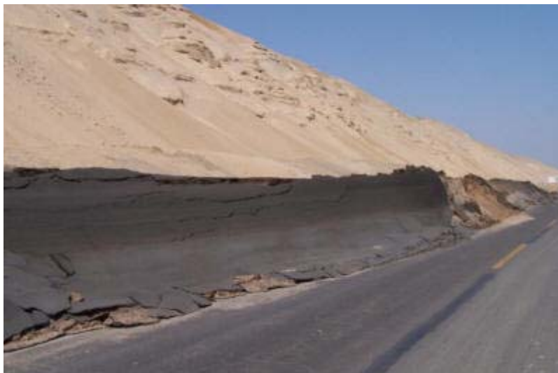
Figura 14: Daños en berma y pavimento de la calzada norte de la carretera Panamericana.
